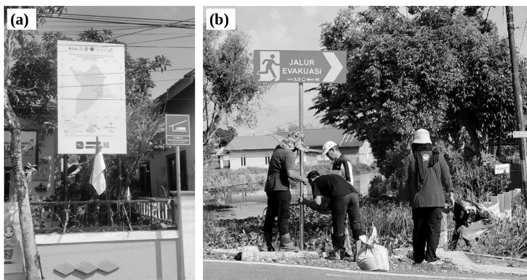
Gambar 7 Prasarana Evakuasi Terpasang: (a) Peta Jalur Evakuasi dan Rambu Tempat Pengungsian di Kantor Kelurahan; (b) Rambu Jalur Evakuasi di Jl. Krisna RT 21
